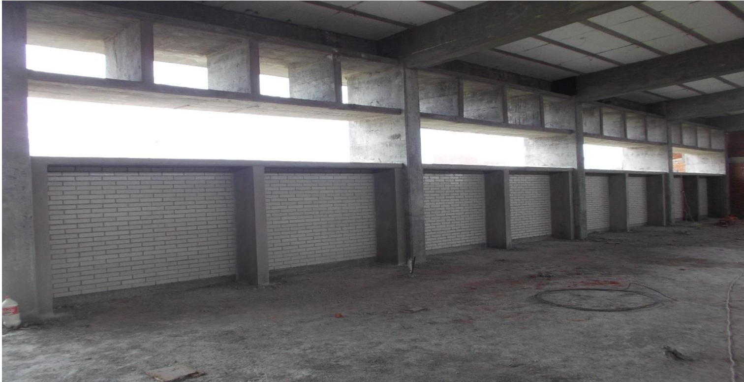
CONSTRUCCION DE REPIZONES DE CONCRETO ARMADO, PARTE SUPERIOR DE MUROS APARENTES ACABADO ESMALTADO
