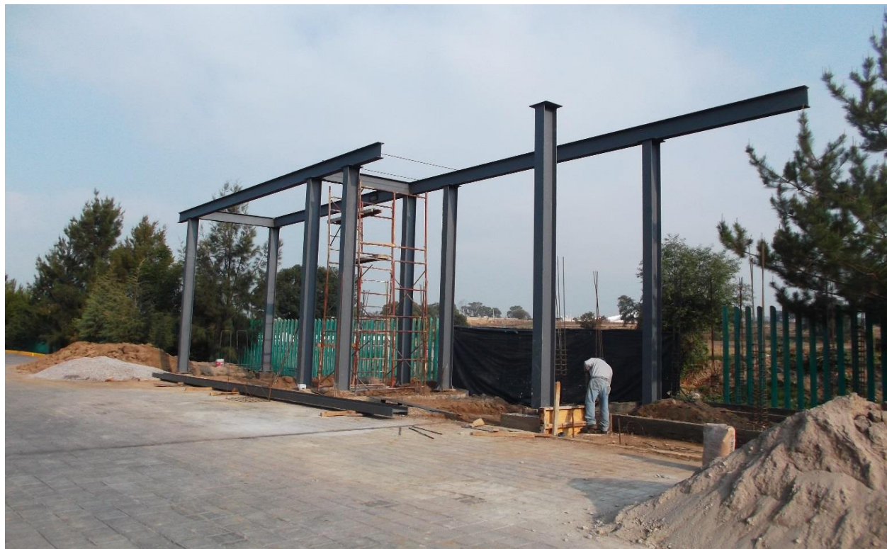
OBRA EXTERIOR: SUMINISTRO Y COLOCACION DE ESTRUCTURA METALICA; COLUMNA, TRABES (ACCESO NORTE)
