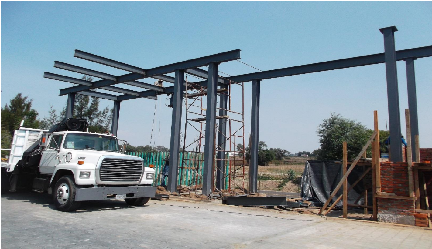
OBRA EXTERIOR: SUMINISTRO Y COLOCACION DE ESTRUCTURA METALICA; TRABES, LARGUEROS (ACCESO NORTE)
