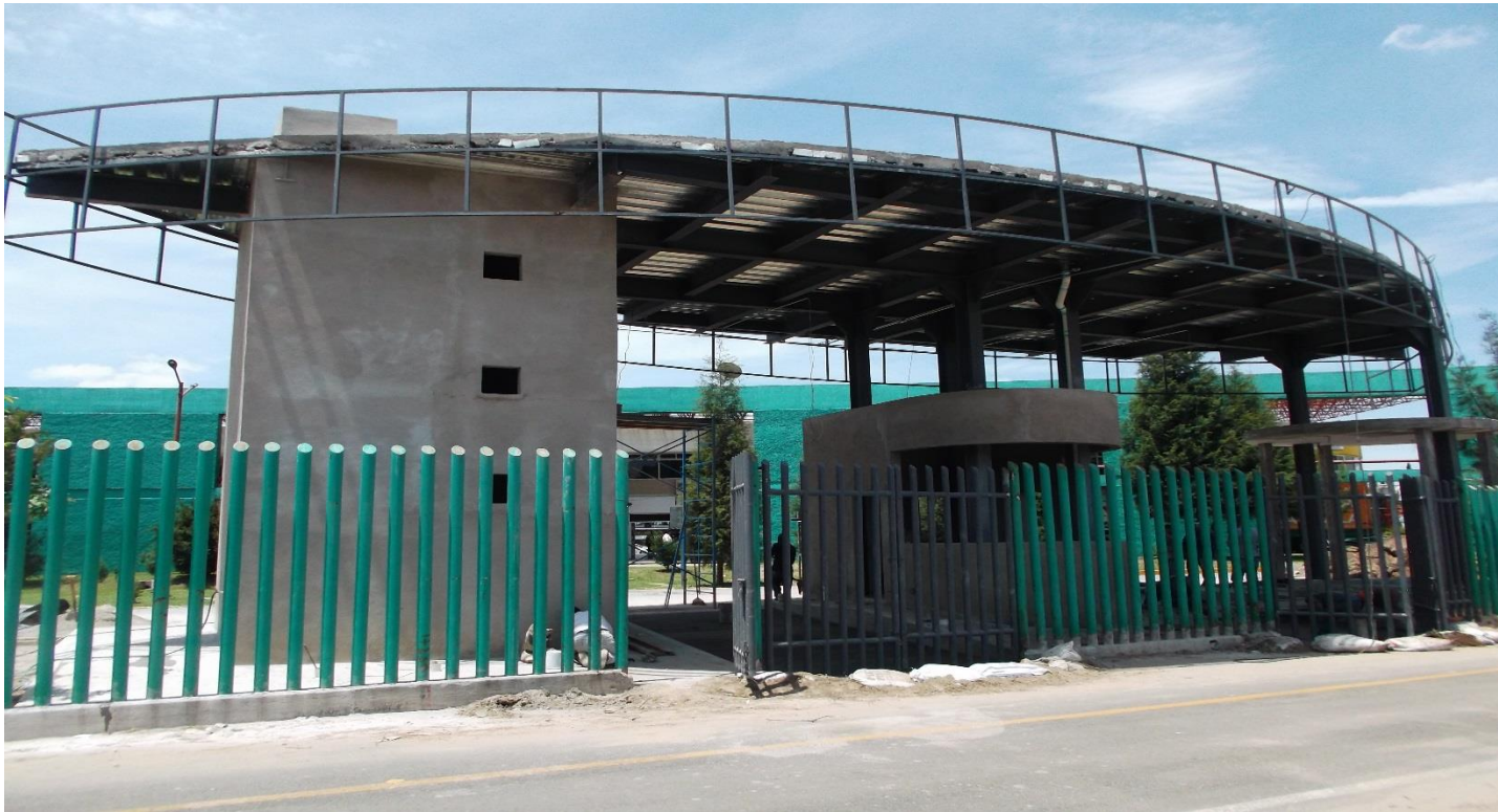
OBRA EXTERIOR: SUMINISTRO Y COLOCACION DE PORTONES METALICOS EN ACCESO PRINCIPAL (ACCESO NORTE)
