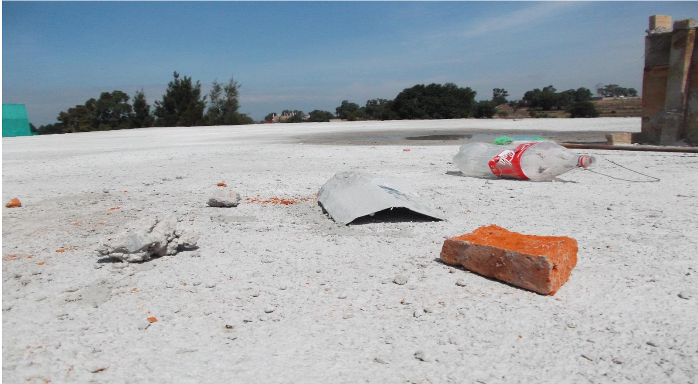
OBRA EXTERIOR: CURADO A BASE AGUA EN LOSA DE CONCRETO DE AZOTEA (ACCESO NORTE)
