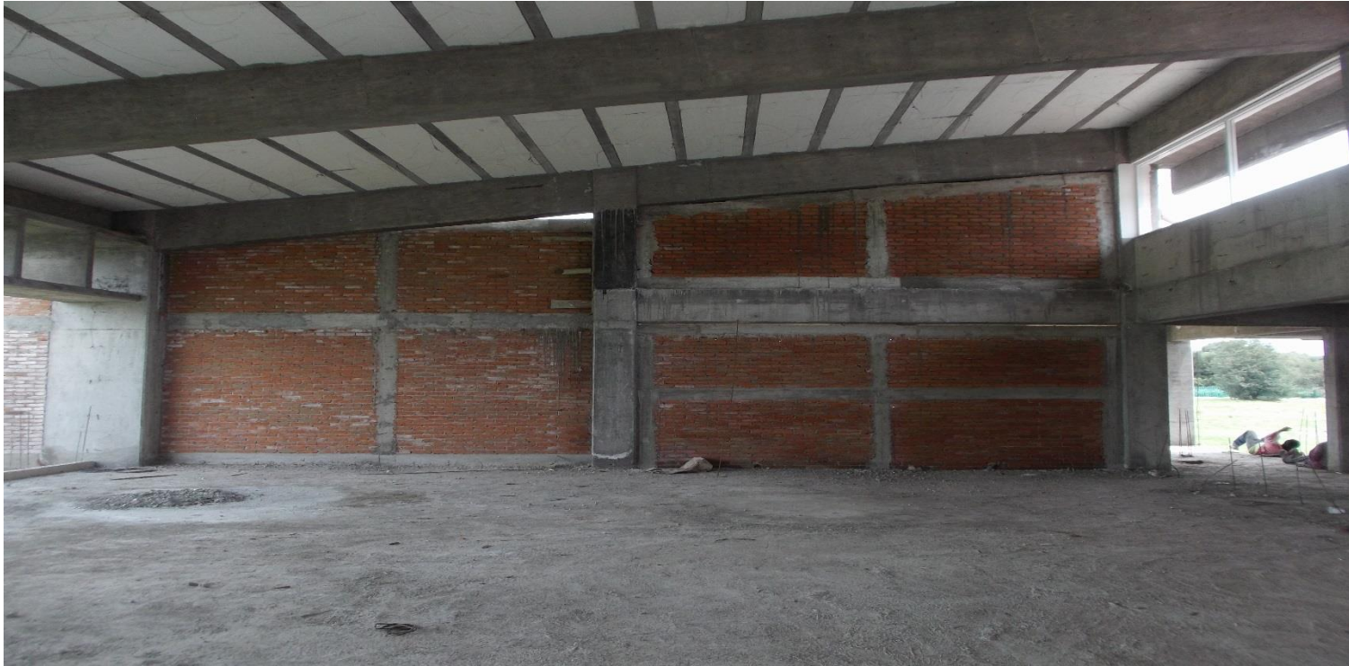
CONSTRUCCION DE CADENAS Y CASTILLOS DE CONCRETO Y MUROS DE TABIQUO ROJO COMUN INTERIORES
