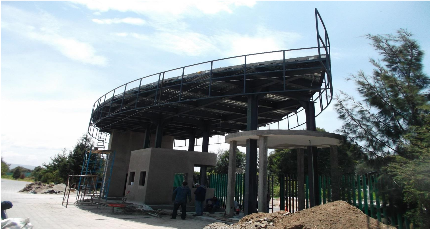
OBRA EXTERIOR: SUMUNISTRO Y COLOCACION DE BASTIDOR METALICO CON PERFILES "AR" PARA RECIBIR PANELES DE ALUMINIO ALUCOBON (ACCESO NORTE)
