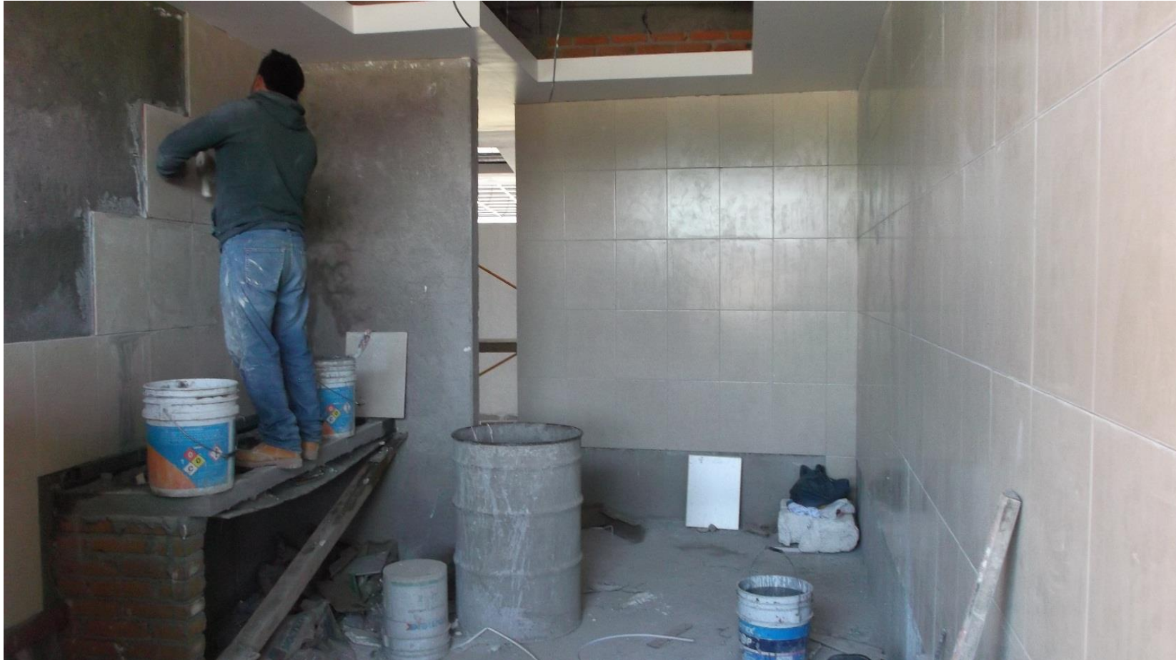
COLOCACION DE LOSETA DE CERAMICA EN MUROS DE SERVICIOS SANITARIOS DE PLANTA BAJA.
