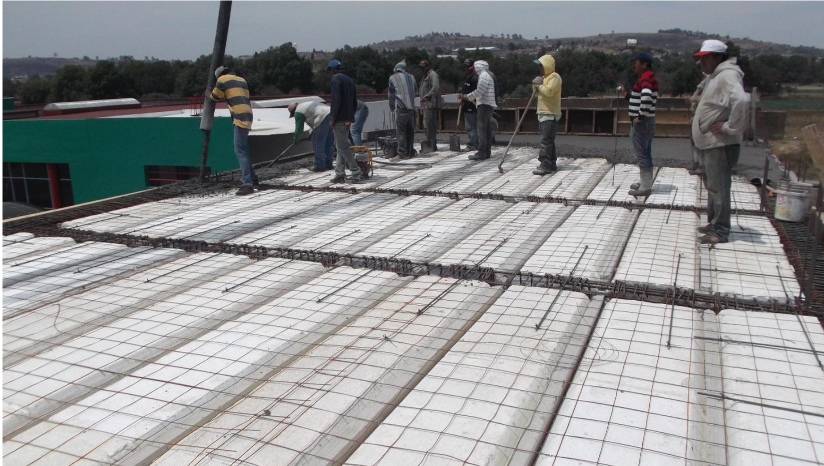
COLOCACION DE VIGUETAS PRETENSADAS Y CASETONES DE POLIESTIRERNO EN LOSA DE AZOTEA NIVEL +9.80 M.
