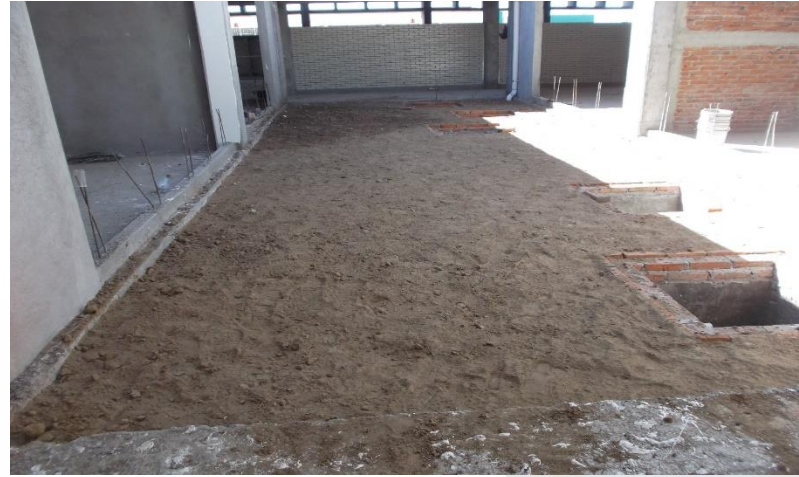
RELLENO CON MATERIAL INERTE EN PATIOS INTERIORES PARA ENRRASAR CON EL NIVEL DE PISO TERMINADO GENERAL
