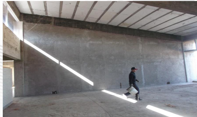
EDIFICIO LT-3. APLANADO EN MUROS DE RECIENTE CONSTRUCCIÓN PARA LABORATORIOS DE QUÍMICA
