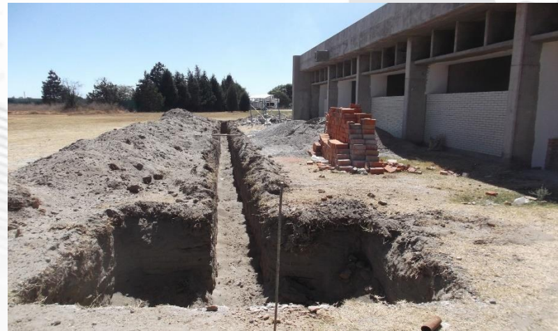
OBRA EXTERIOR: EXCAVACIÓN DE CEPAS PARA LA INSTALACIÓN DE LA RED DE DRENAJE
