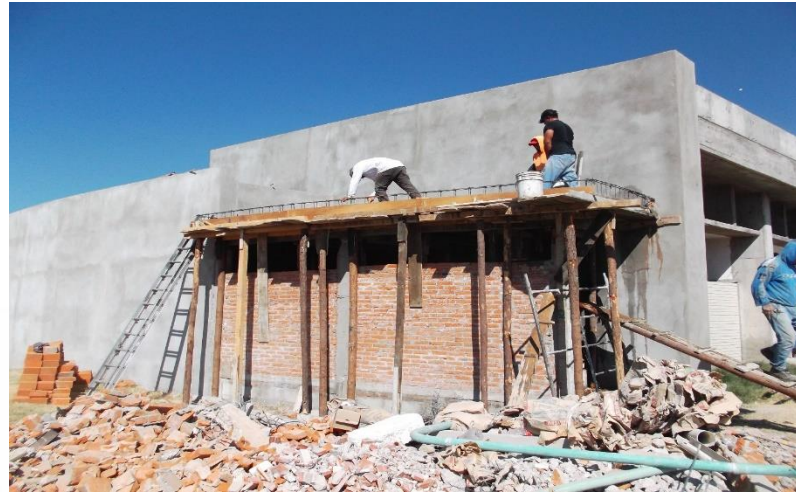
EDIFICIO LT-3. COLADO DE LOSA DE CONCRETO HECHO EN OBRA F' C=200 KG/CM2 EN ÁREA DE ALMACÉN DE RESIDUOS TÓXICOS.
