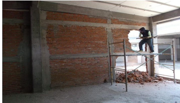
DEMOLICIÓN DE MUROS EXISTENTES PARA LA ADAPTACIÓN DE LABORATORIO DE QUÍMICA GENERAL SOLICITADA POR EL DIRECTOR DE CARRERA
