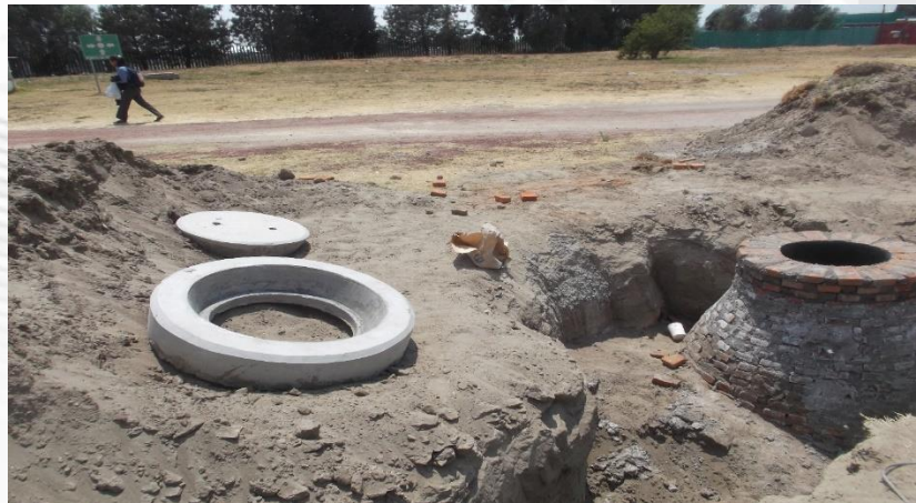
OBRA EXTERIOR: SUMINISTRO DE BROCALES DE CONCRETO PARA POZOS DE VISITA DE RED DE DRENAJE EXTERIOR.
