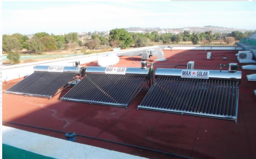
GIMNASIO UNIVERSITARIO: SUMINISTRO, COLOCACIÓN Y CONEXIÓN DE CALENTADORES SOLARES EN AZOTEA DEL GIMNASIO
