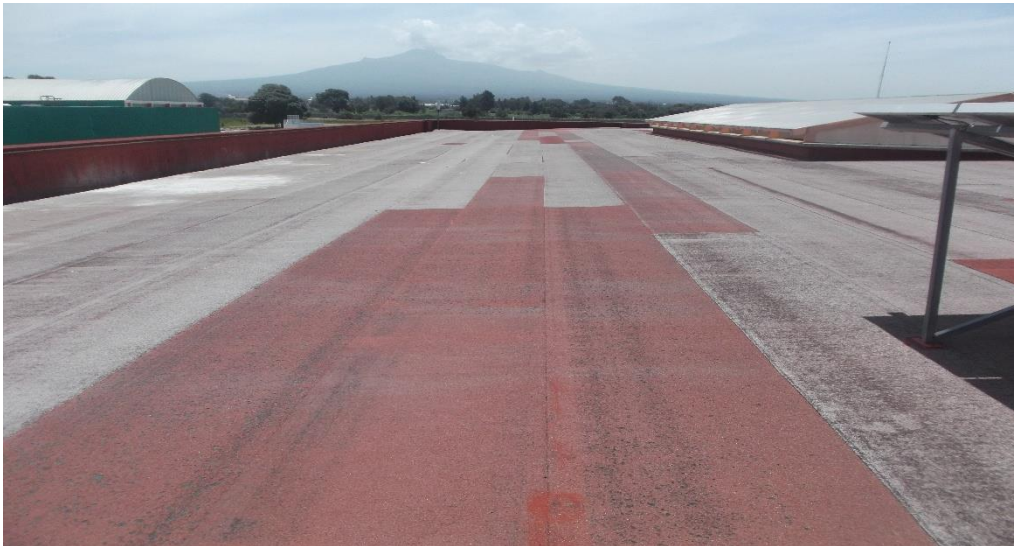
IMPERMEABILIZACION DE LOSA DE AZOTEA DEL EDIFICIO UD-2 EN MAL ESTA
