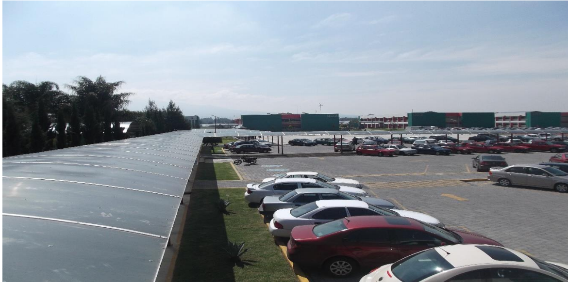
CUBIERTA PLASTICA CON LAMINA DE POLICARBONATO EN ANDADORES EXTERIORES.
