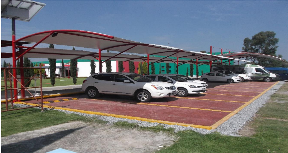
CUBIERTA CON ESTRUCTURA METALICA Y VELARIAS EN EL ESTACIONAMIENTO PARA VEHICULOS OFICIALES.
