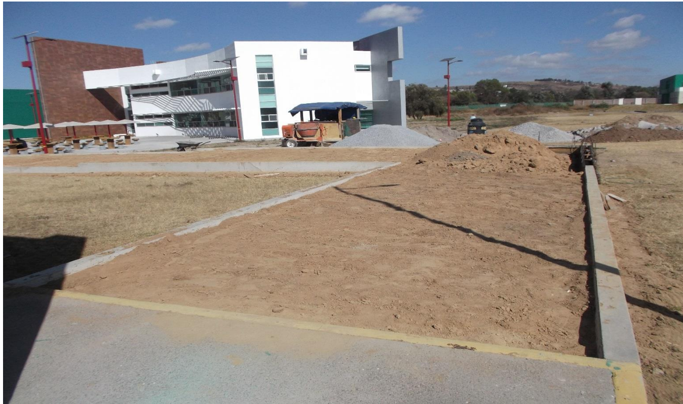
OBRA EXTERIOR: RELLENOS COMPACTADOS Y CONSTRUCCIÓN DE GUARNICIONES DE CONCRETO PARA LA CONTINUACIÓN DEL ANDADOR PRINCIPAL.
