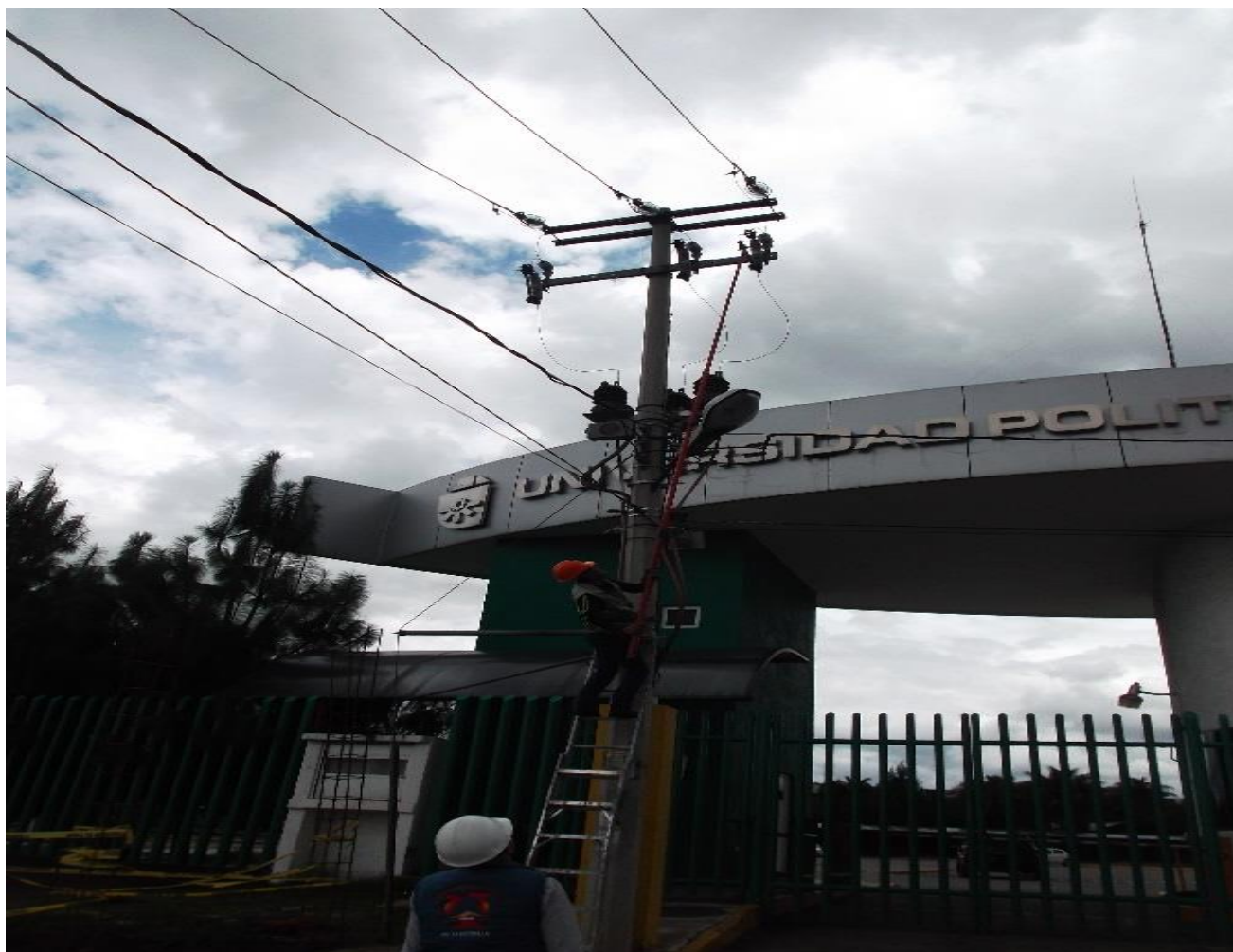
BAJANDO LAS CUCHILLAS DE LA LINEA DE C.F.E. PARA CORTAR EL SERVICIO DE ENERGIA ELECTRICA AL INTERIOR DE U.P.T.
