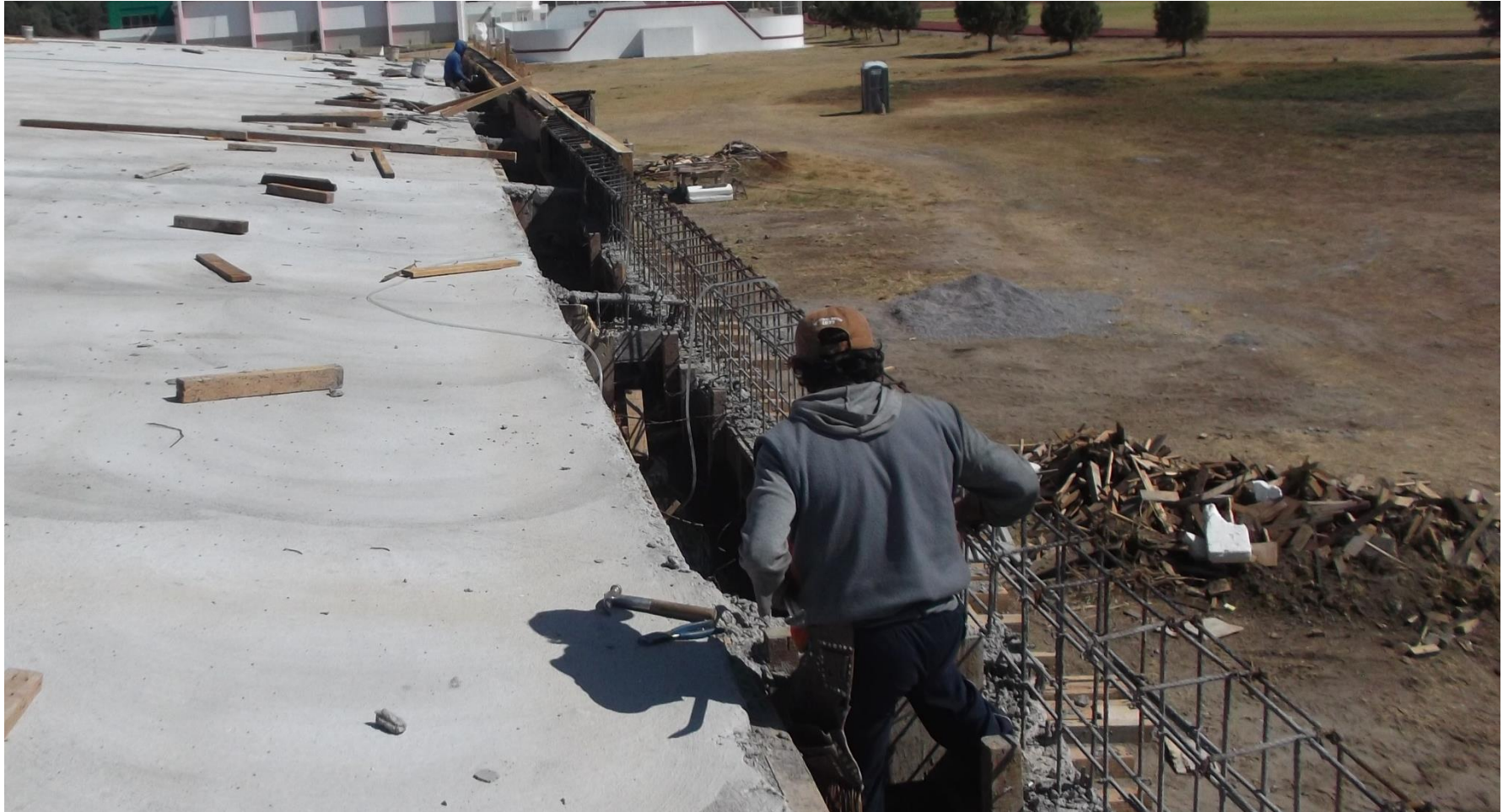
TRABAJOS DE CIMBRA EN FALDÓN PARA RECIBIR VACIADO DE CONCRETO F' C = 250 KG/CM2.
