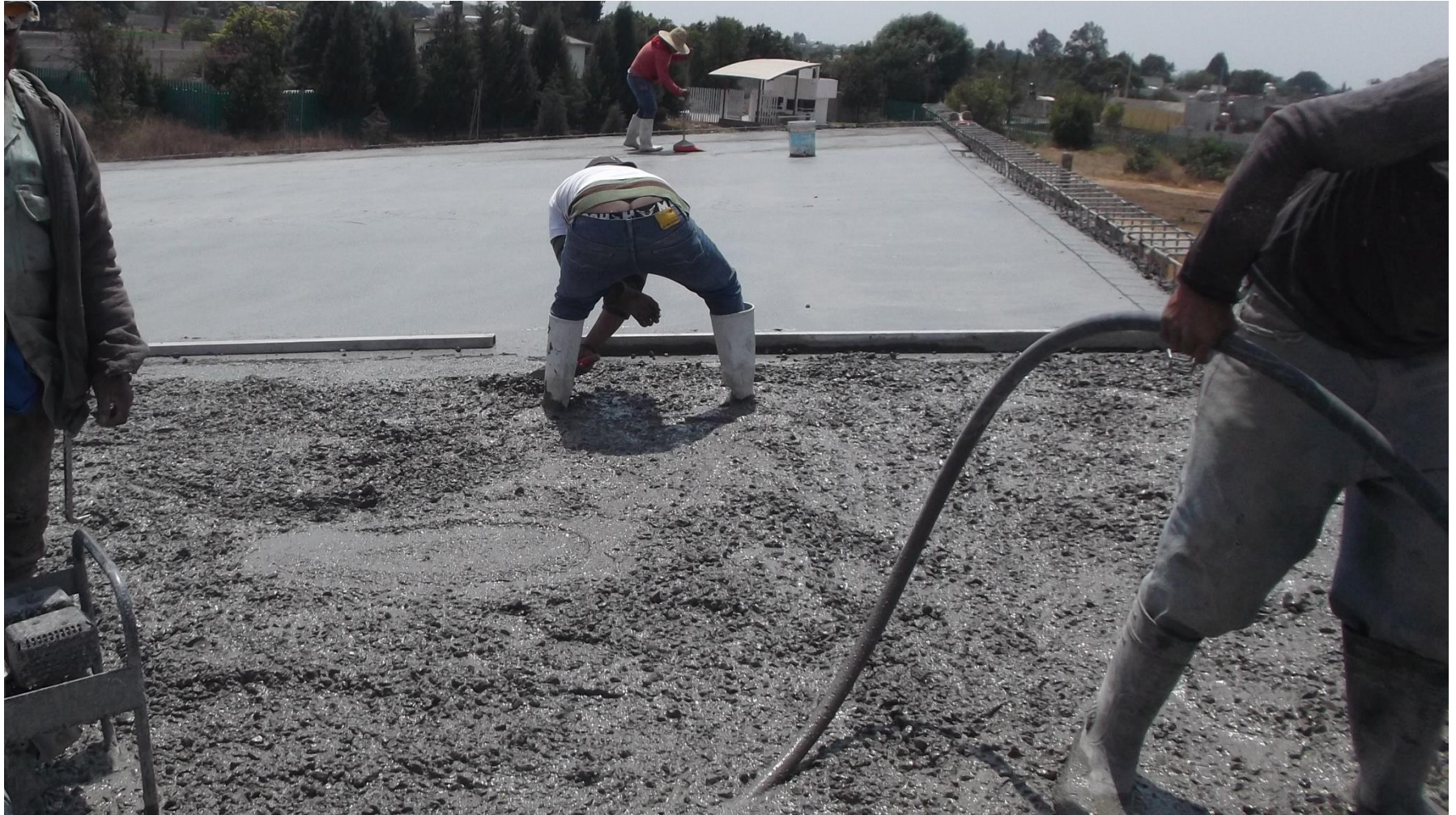
VACIADO DE CONCRETO EN LOSA. AL FONDO TRABAJOS DE APLANADO Y BARRIDO DE LOSA COMO PARTE DE EL CURADO DEL CONCRETO
