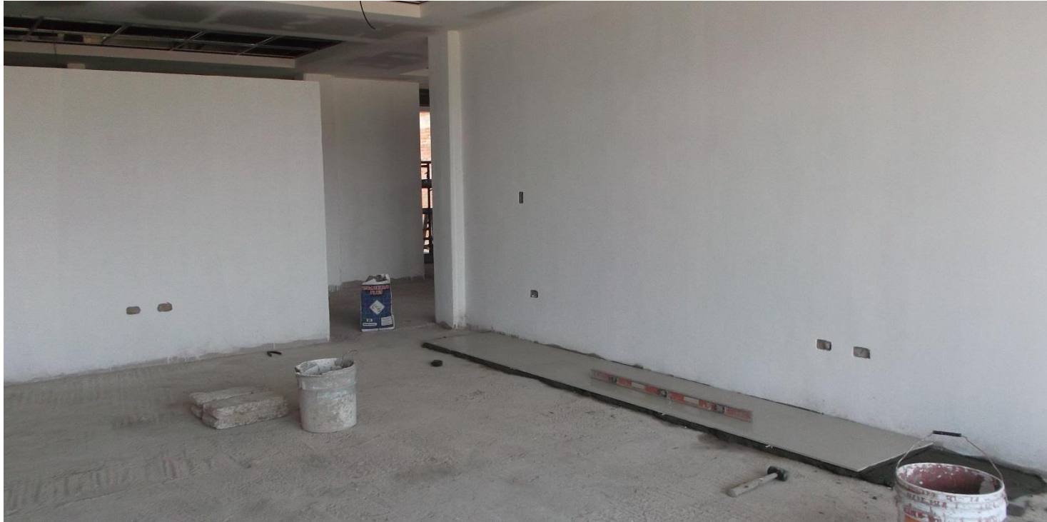
APLICACIÓN DE SELLADOR EN MUROS (FONDED) PARA RECIBIR PINTURA VINILICA E INICIO DE COLOCACION DE LOSETA.
