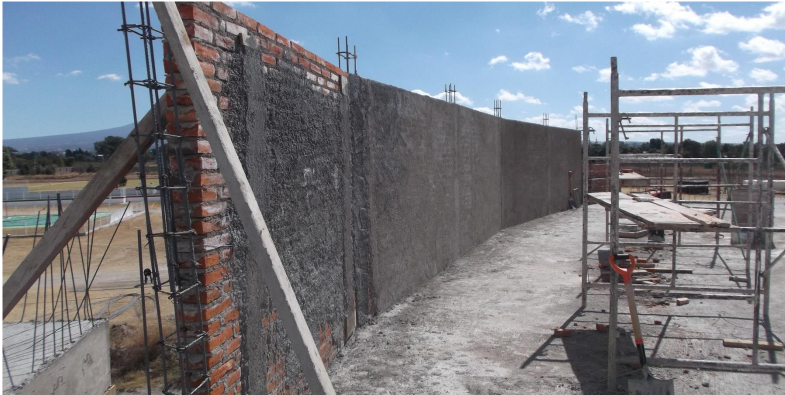
APLICACIÓN DE APLANADOS DE MEZCLA EN PRETEL DE TABIQUE EN LOSAS DE AZOTEA.
