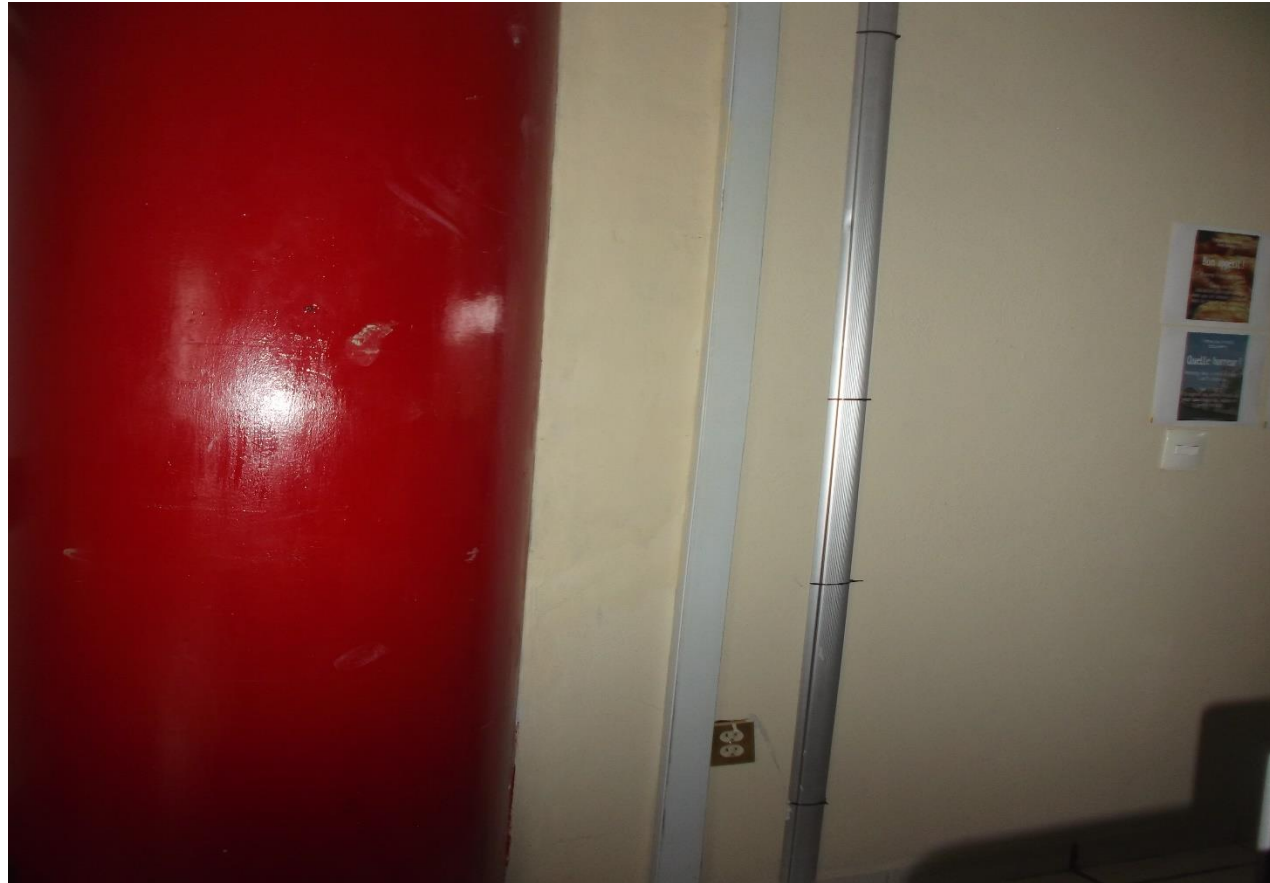
RESANE DE FISURAS DE JUNTA FRIA DE MUROS DIVISORIOS CON ESTRUCTURA DE EDIFICIOS UD-2
